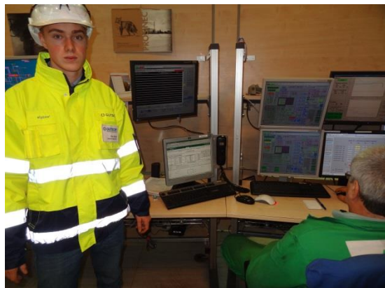
Obrázek 19: Velín a řízení provozu teplárny United Energy (Vlastní foto, 2015)
