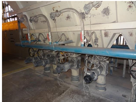
Obrázek 15: Výsypky fluidního kotle se stacionárním ložem (Vlastní foto, 2015)
