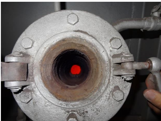
Obrázek 18: Pohled do fluidního lože kotle za provozu (Vlastní foto, 2015)
