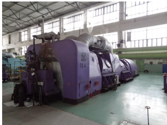
Obrázek 17: Turbogenerátory – strojovna United Energy (Vlastní foto, 2015)
